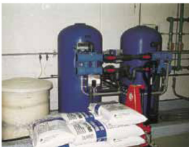
Ion Exchanger/ Intercambiadores iónicos
